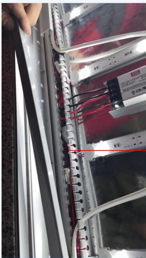
灯箱内部电线使用收纳线盒收纳整齐
